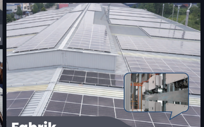
Fabrik Malaysia 1,2 MWp PV-Kapazität | 0,88 MW AC-Ausgang
